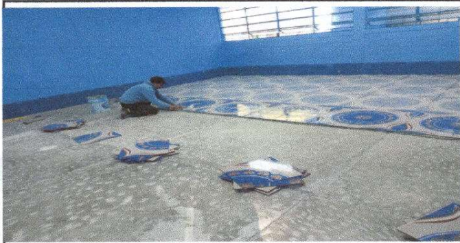
Foto 3: Piso de dos aulas deterioradas
