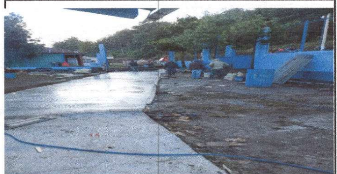
Foto 4: Gran parte del patio necesita torta de cemento.
